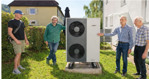
Nachhaltige Energieversorgung: Zwei Wärmepumpen sorgen für Heizung und Warmwasser – unterstützt durch selbst erzeugten PV-Strom vom Dach.
